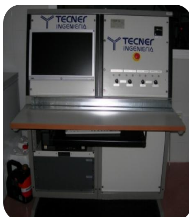
Figura 6. Consola de control A1
